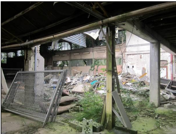
Binnenzijde loods met ingestorte dak.
