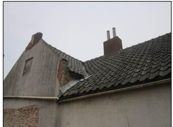
Dak van woning met openingen/kieren tussen dakpannen.
